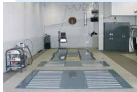
ネットワークシステムを導入した検査ライン
