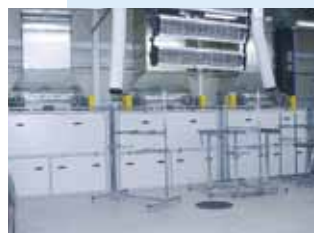
各ストールの吸塵ビット1列に1台、3台の集塵機を設備
