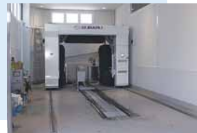
洗車ストールには自動下部洗浄機も設備
