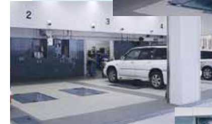
タイル張りの床面、リールもエアコンのダクトも壁の裏に設置
