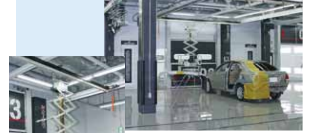
3つのラインに3基の塗装ブースが並ぶ。 右端の塗装ブースはテーブルリフターを内蔵
