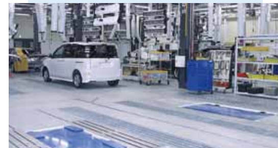
すべてのストールに集塵ビットと吊下げ乾燥機、およびエアコンダクトを設備
