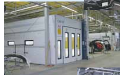
塗装ブースは2基、スライドバルレットで横からの入庫が可能
