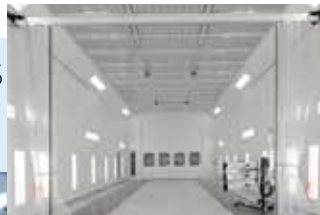
ブースの前後で照明を2段階に、前部分は乗用車用に2600lxの照度としている。
