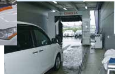
洗車ストールには門型洗車機ニュートX、高圧温水洗浄機ナイスホットKHW-1100Cを設備。
