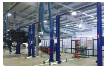
ずらりと並ぶゲートリフトⅡ、移動式の排気ホースも完備
