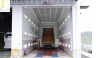
建屋一体型の塗装ブースで下回り塗装の乾燥時間も大幅に短縮
