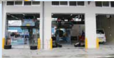
右側の3ストールにはフラットタイプの埋設リフトを導入
