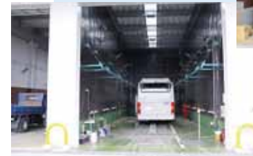
洗車場には「プラトン10」、下部洗浄機、洗車ホースの架台を設備
