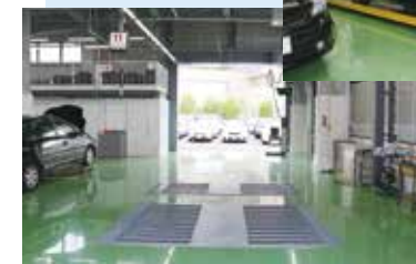
固定式フリーローラーを設備した検査ライン
