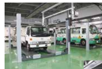
トラック、バスのサービスに6.5t能力の4柱リフトが2基
