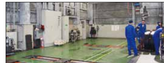
検査ラインにはブレーキ・スピードテスト2基を効果的に配置しました。
