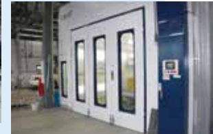
ライン右側の塗装・乾燥ブースは、側面オーバードア仕様
