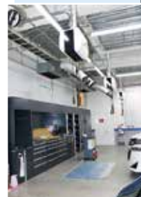
大型キャビネットで整理整頓を徹底。 ストールごとに冷暖房を完備
