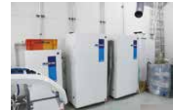
臭気対策にデオスターを設備。
