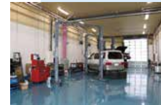
小型車3ストール、ゲートリフト3基を設備
