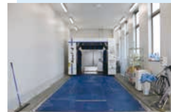
門型洗車機と下部洗浄機、床面にはFRPグレーチングを採用した屋内洗車場
