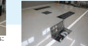
埋設排気装置も屋内サービスに不可欠
