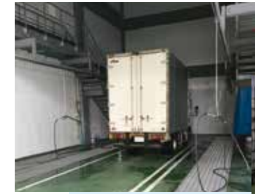
右側洗車ストール、高所からの洗浄も行える。
