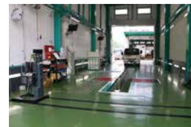
検査ラインにはネットワークシステムを導入、ピットにはフロアリフトを設備
