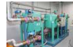
各ストールから真空装置で廃油、廃LLC、ブレーキダストを回収
