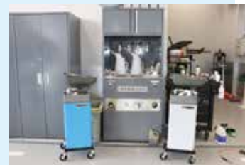
4連オイルサーバー。右はオイル、左はLLC専用のドレンカート。
