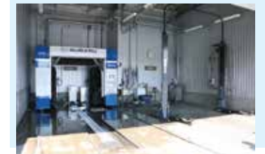
洗車場は2ストール。門型洗車機と自動下部洗浄機も設備。
