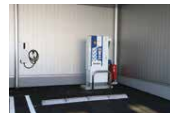
急速充電設備は1基、普通充電器は各所に設置。
