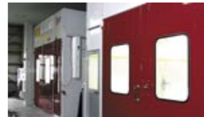
塗装ブースも2基設備
