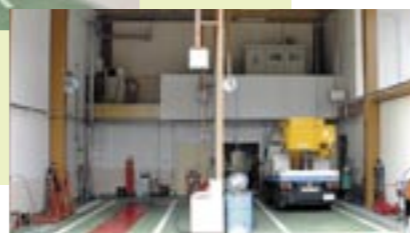
ツインエースを導入した大型車整備ストール
