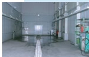
左右にガンを設備した洗車場、ホースをレールに架設し、作業性抜群
