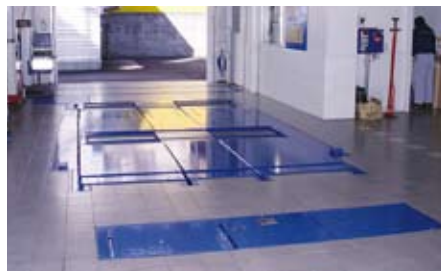
スーパーマルチテスター、ネットワークシステムを導入した検査ライン
