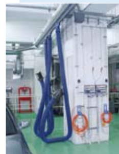
すべてのフロア、ストールに 排気ガス排出リールを備える (1F)
