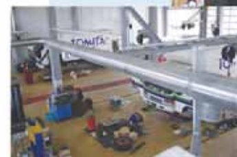
暖房ダクトで工場全体に 温風を供給
