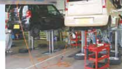
タンデムリフトで幅広い車種に対応、スポットクレーンも全てのストールに
