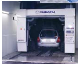
エミネットβIIと自動下部洗浄機を 設備した洗車場
